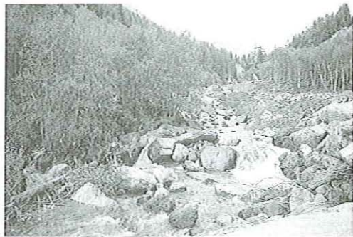
Fig. 8 - Tratto del torrente Maso di Spinelle sistemato con briglie in massi posati a secco.
