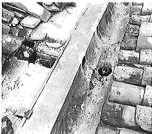
Fig. 10 - Il troppo "troppo pieno" realizzato in due punti del lungo compluvio, per "avvertire", considerato che l'acqua entrerà nell'edificio, che è tempo di pulire la gronda!
